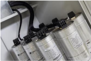
تصویر ۴ خازن‌های نصب شده در بانک
